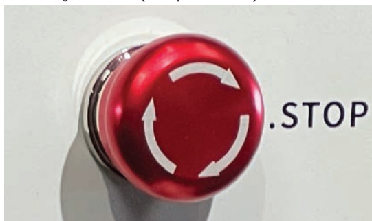
Фото 11.1.1. Кнопка аварийной остановки.
